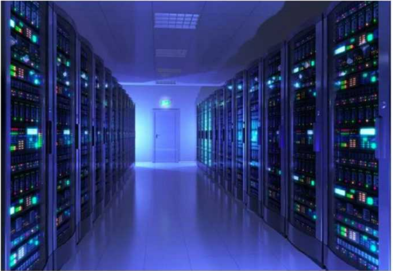
Figura 2. Centro de datos con racks de servidores interconectados, utilizados por empresas de trading algorítmico. Estos centros alojan los sistemas automáticos que procesan noticias, ejecutan decisiones de compra o venta de acciones y se sincronizan con relojes atómicos.
